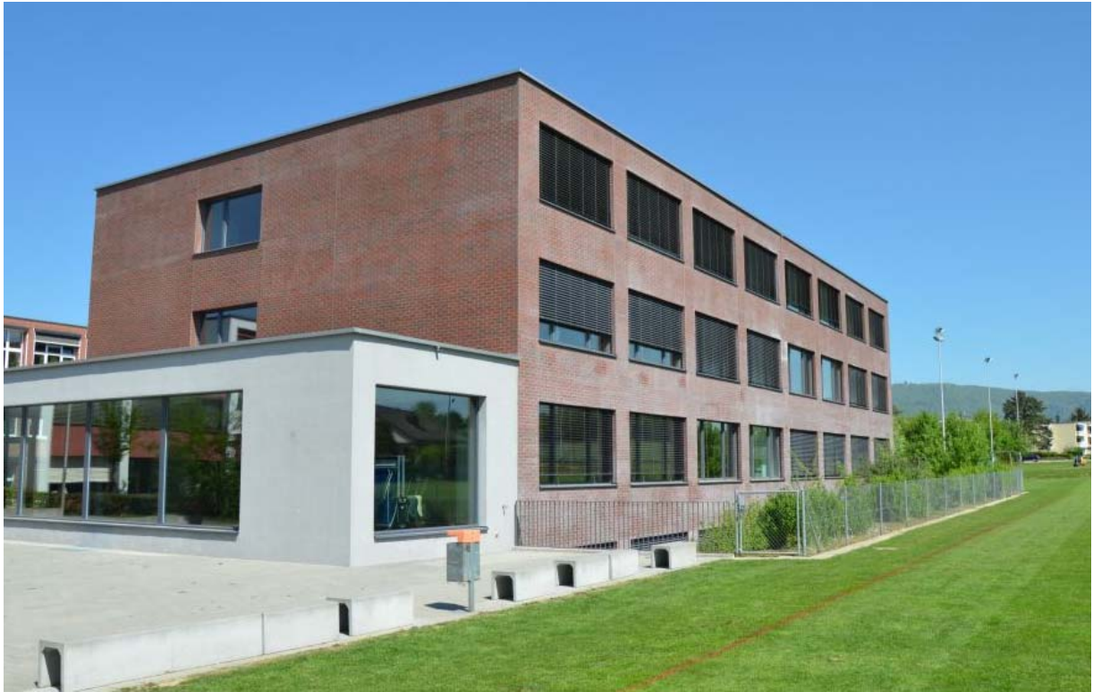
Zustand vor der Nachbehandlung: Weissliche Verfärbungen an der ganzen Fassade
