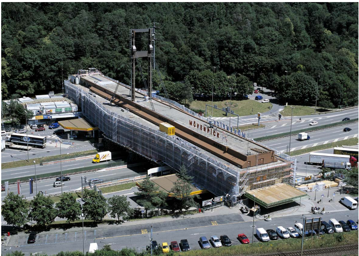
Die grösste Würenloser Baustelle im 2004: Die Autobahn-Raststätte an der Autobahn A1. Sie wurde innen wie aussen total saniert. Die Fassade präsentiert sich jetzt in Blautönen. (Foto Ralph Bensberg / Zschokke)
