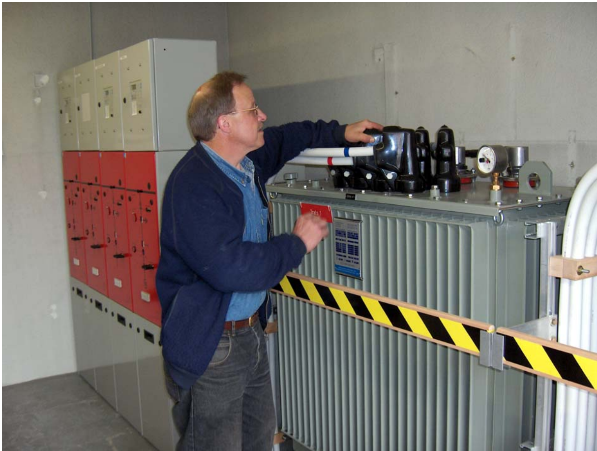
Elektromonteur Gerhard Hauser in der umgebauten Trafostation "Feldstrasse"
