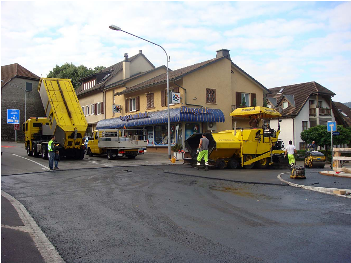
Die Sanierung der Furtbachbrücke im Endstadium: Am Sonntagmorgen des 25. Juli 2010 erfolgten die Deckbelagsarbeiten
