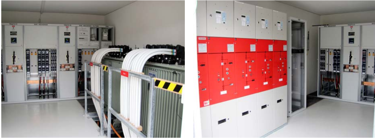
Trafostation Flühstrasse: Neue Schaltanlage.
