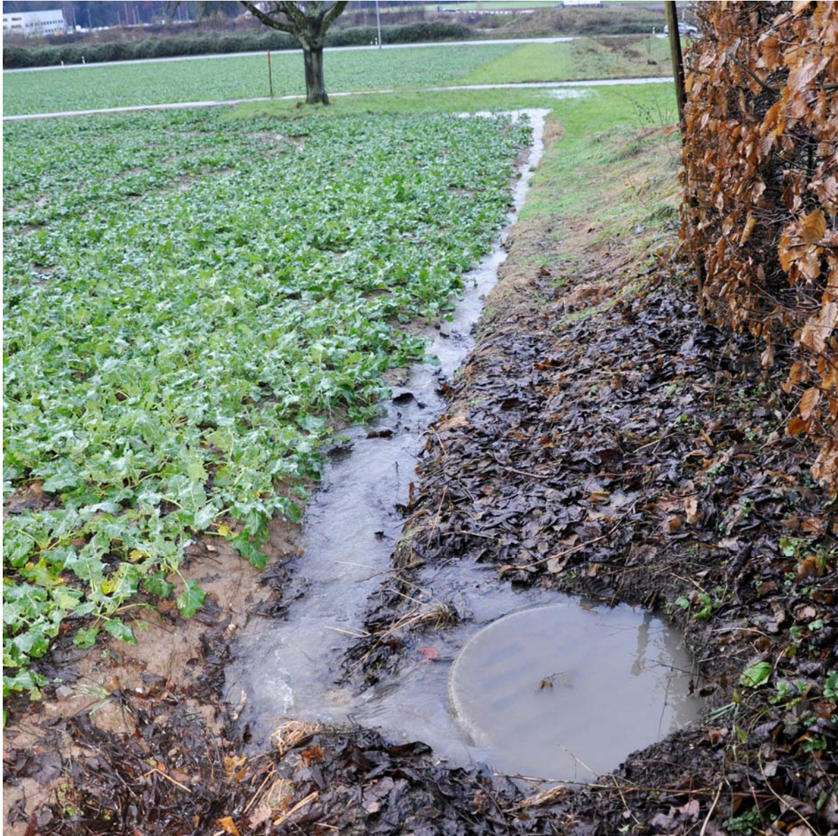
Wegen Wurzeleinwuchs: Drainagewasser tritt im "Bifig" aus einem Kontrollschacht aus.
