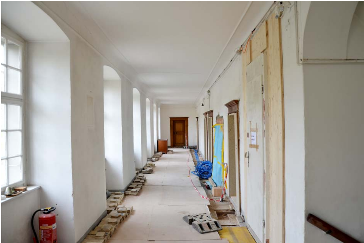
Sanierungsarbeiten im Gang des Propstei-Traktes: Im Boden wurde ein breiter Kabelkanal eingelassen, bevor er anschliessend wieder mit den alten Tonplatten zugedeckt wurde.
