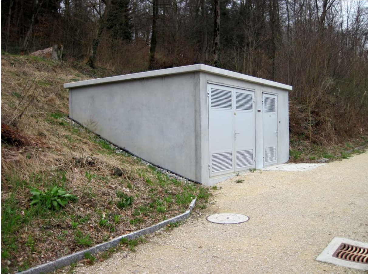
Die neu erstellte Transformatorstation "Raststätte"
