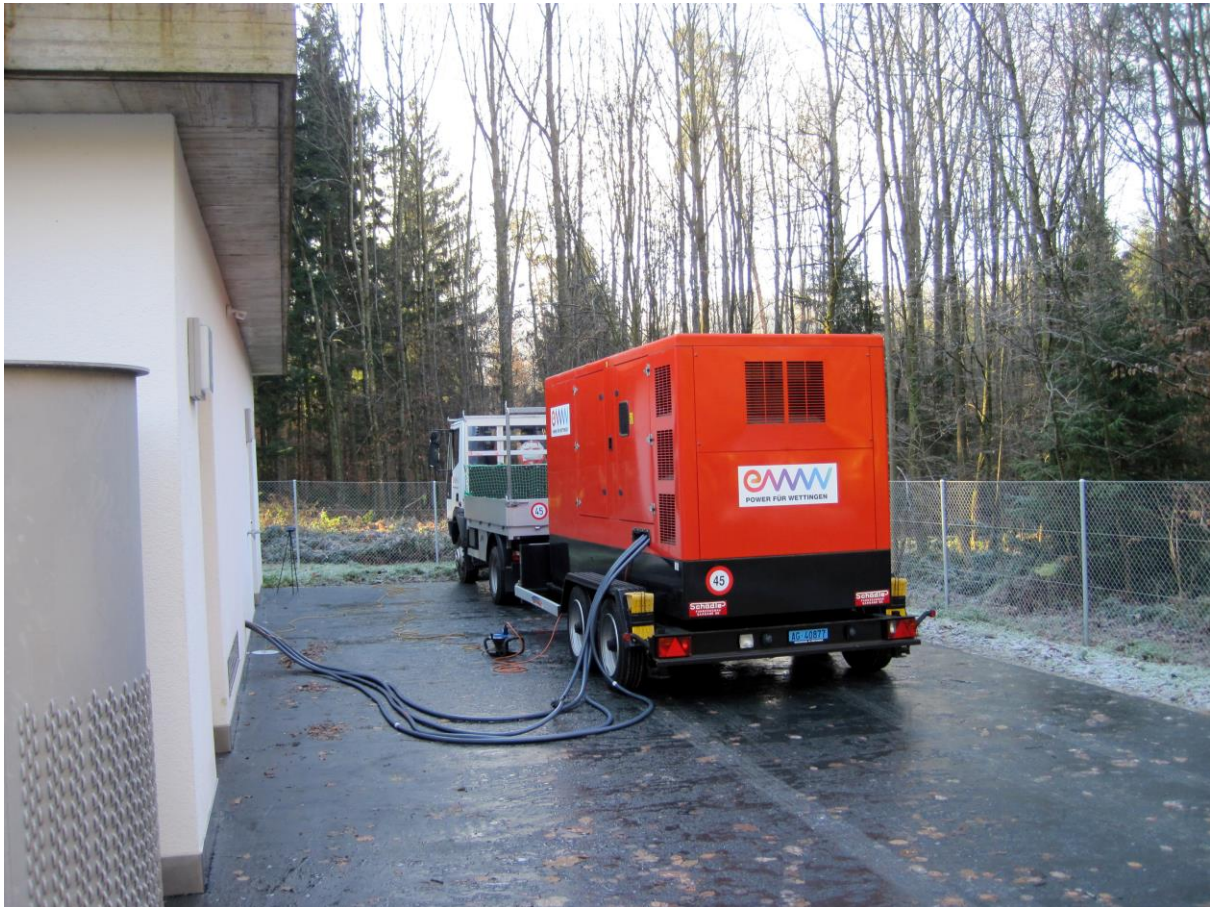
Notstrombetrieb im Grundwasserpumpwerk "Tägerhardwald" mit EW Wettingen AG
