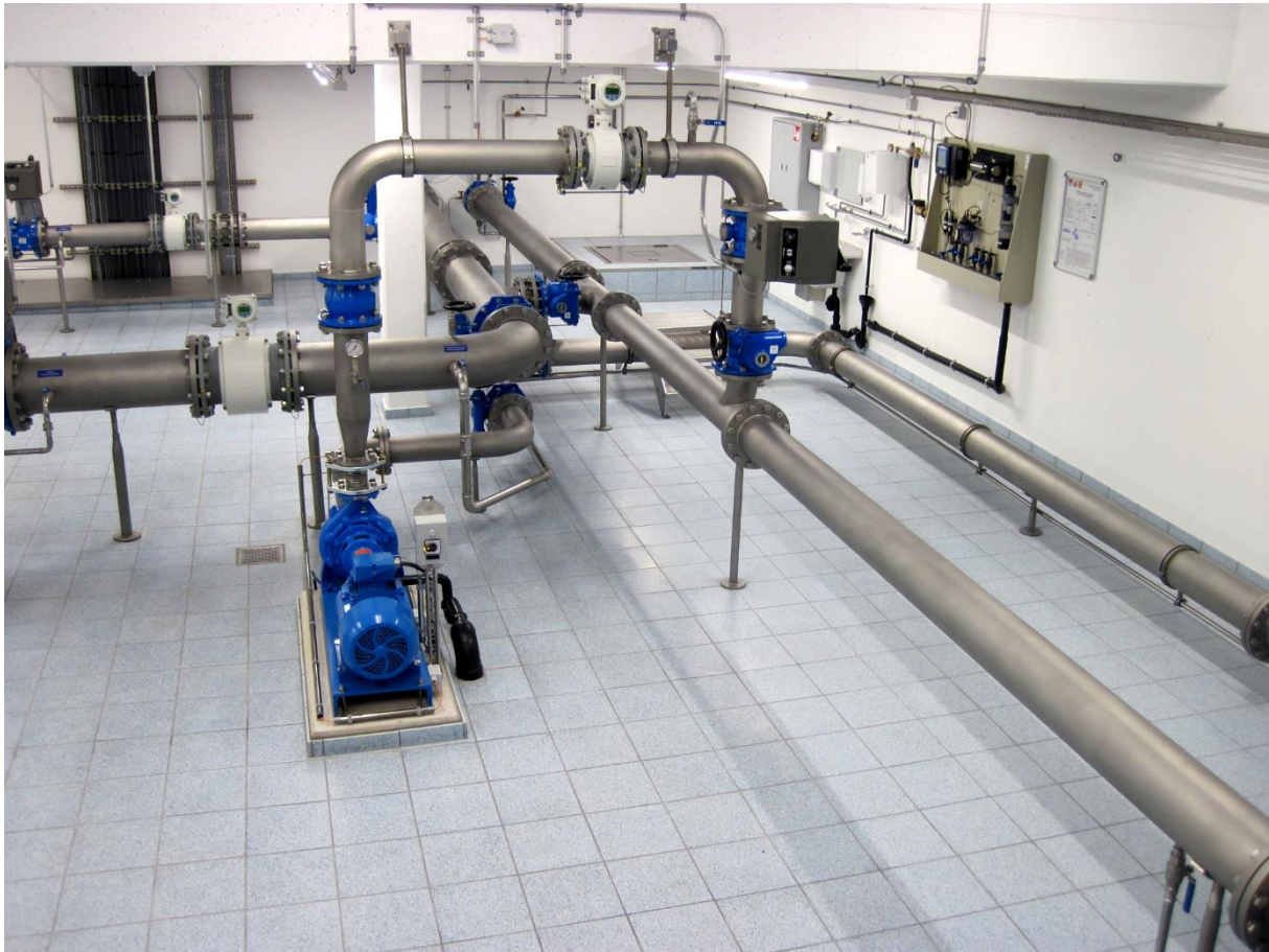
Rohrkeller im Grundwasserpumpwerk "Tägerhardwald"
