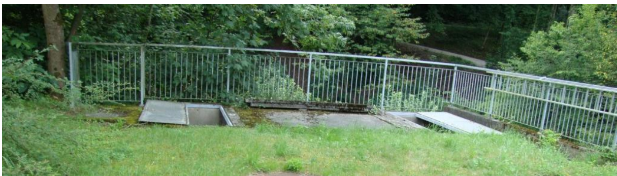
Abbildung 2 Die Arbeitssicherheitsvorschriften werden beim Regenbecken "Träntschi" nicht eingehalten. Hier Blechabdeckungen ohne Absturzsicherung.
