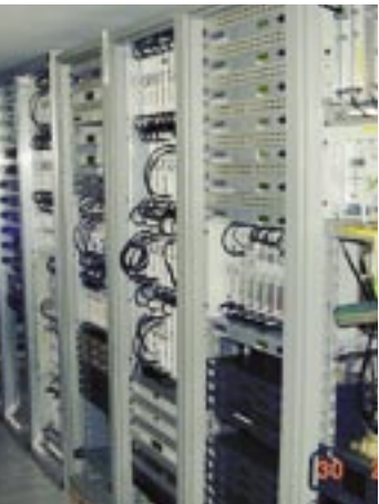
Frontansicht der Signalaufbereitung für Radio und Fernseh-Programme der Catv-Anlage Uitikon-Waldegg und angeschlossene Netze.
