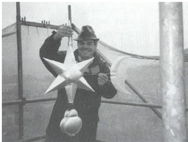
Turmkugel, Kreuz und Wetterfahne in neuem Glanz. Spenglermeister Käufeler setzt der goldenen Pracht die Spitze auf.
