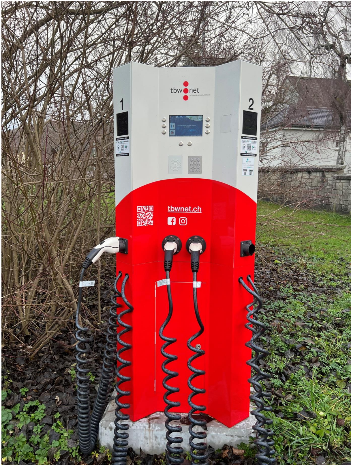
E-Ladestation der TBW an der Gipfstrasse
