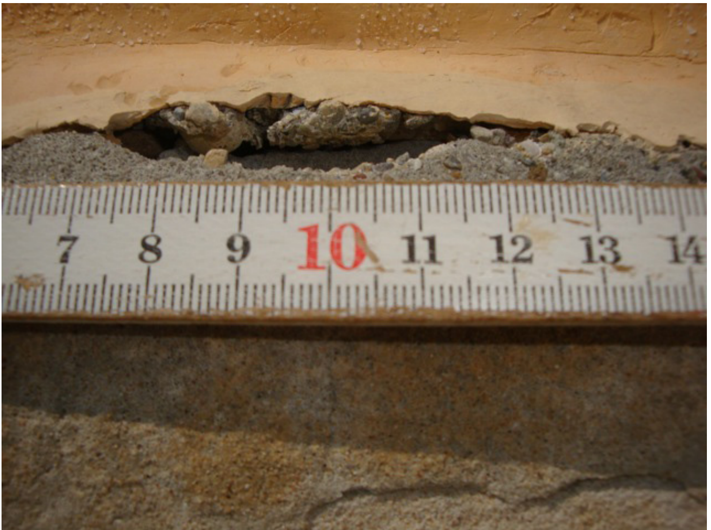
Beispiel eines Risses
